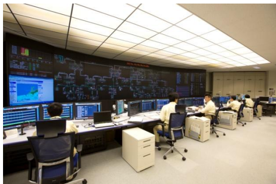
効率的な需給運用への取組み（中央給電指令所）
