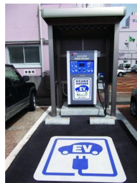
急速充電装置（小松支社）
