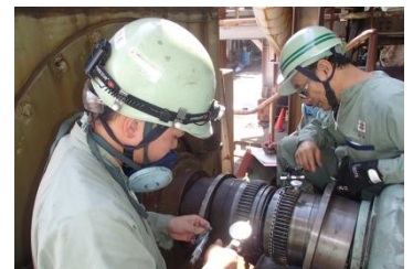
富山火力4号機定期点検の様子 (北陸発電工事)
