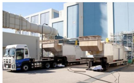
大容量電源車の配備
