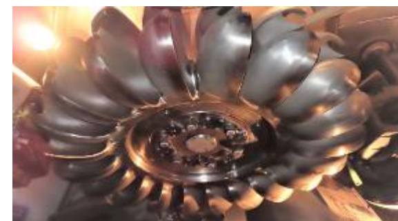
栃尾発電所ランナ (水車羽根車)
