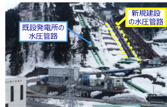
新姫川第六発電所
