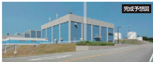
緊急時対策棟の設置(免震構造, 独立電源) 工事中:平成24年度内完了予定
