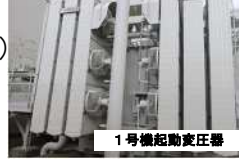
1号機起動変圧器
