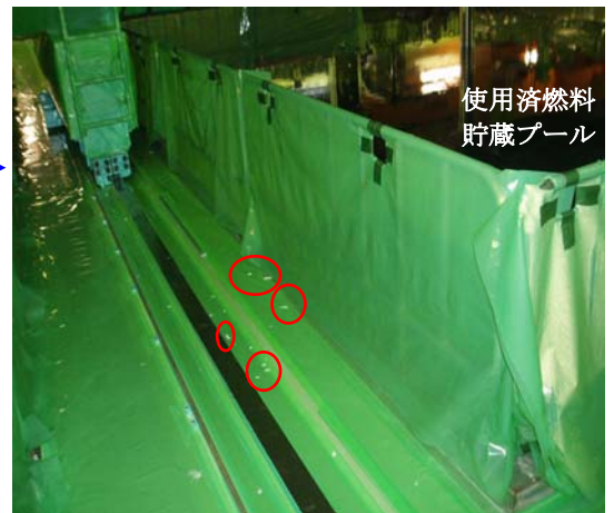
○：破片の飛び散り状況
