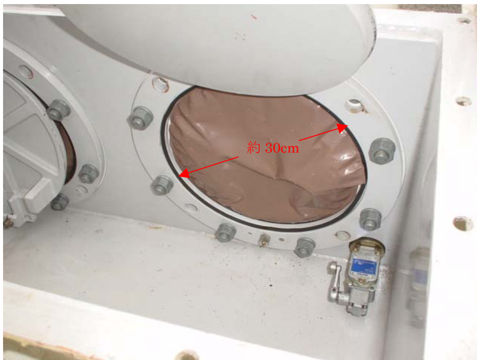
志賀 1号機主変圧器 放圧板の状況 (放圧装置の保護板を開けた状況)
