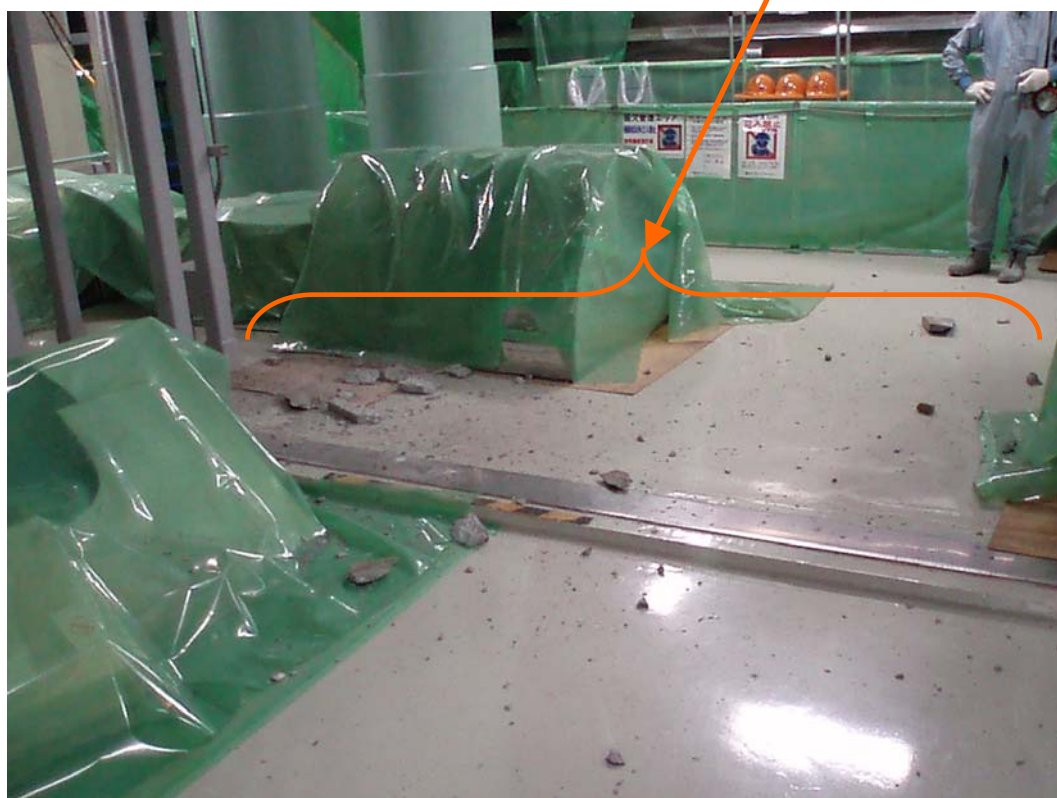
コンクリート片が落下して床に散らばった状況
