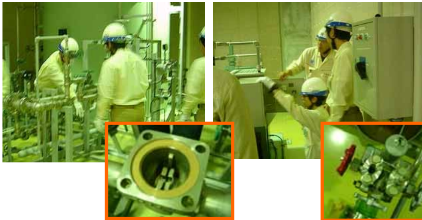
【模擬異常例：弁体の脱落】
