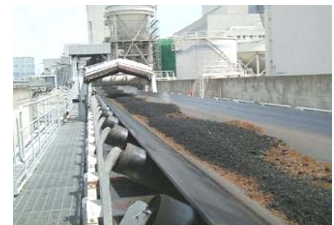
木質バイオマス混焼燃料搬送状況 (石炭+木質バイオマス)
