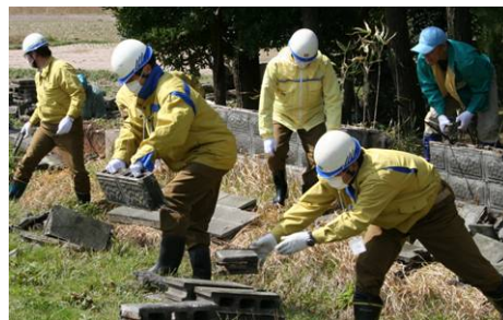
能登半島地震後の復旧支援（民家のブロック塀撤去作業）
