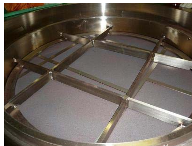
<排ガス再結合器内部>
