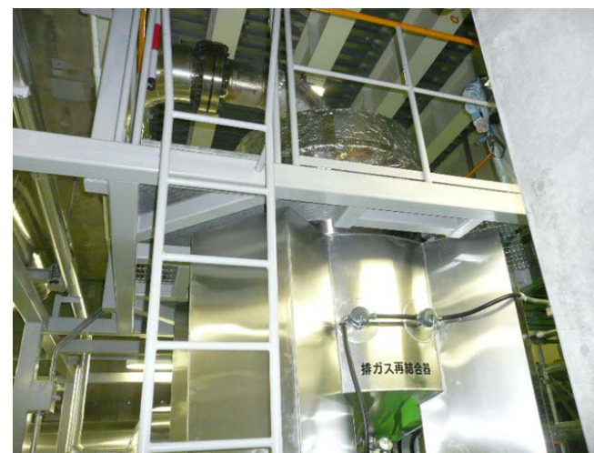
<排ガス再結合器外観>
