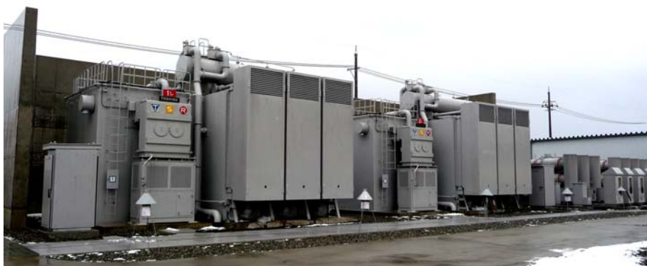
黒部変電所新設 (連系用変圧器)
