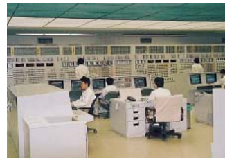
火力発電所中央制御室
