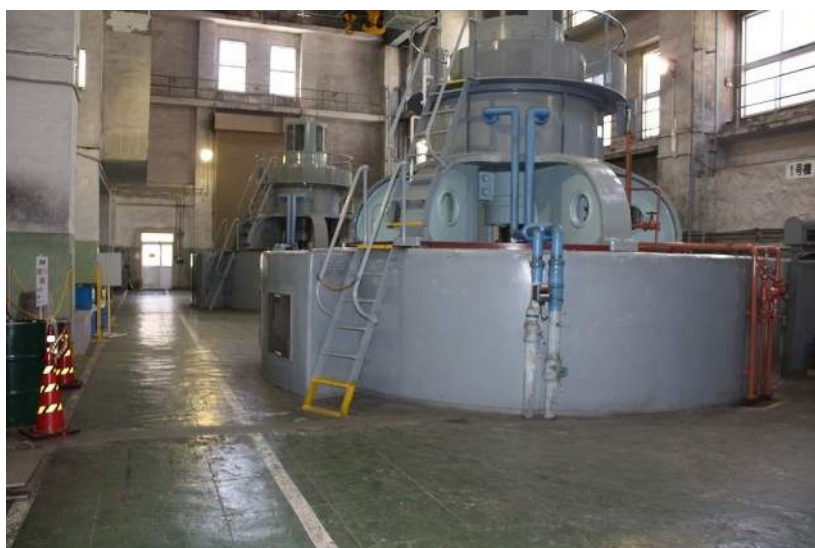
東町発電所 発電機
