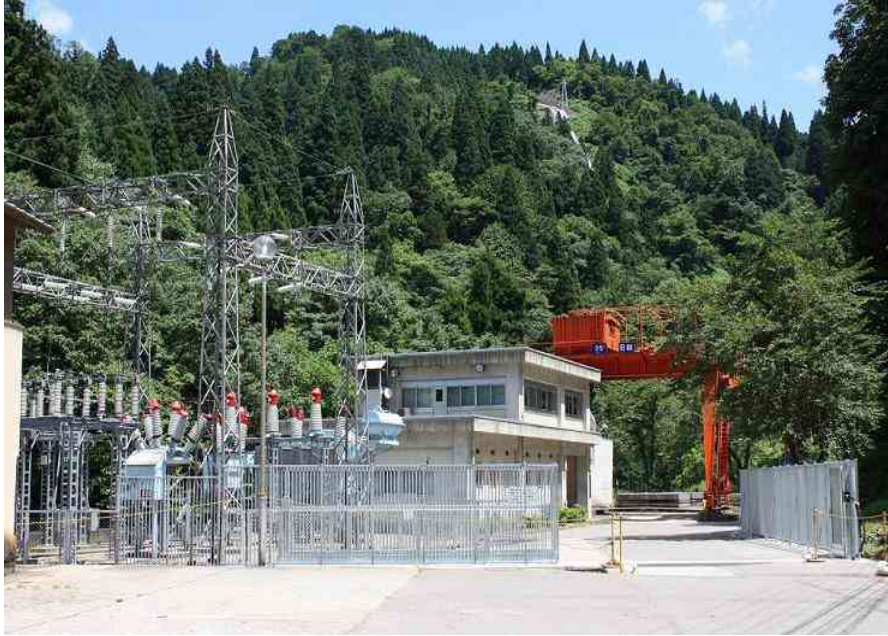
滝波川第一発電所 全景
