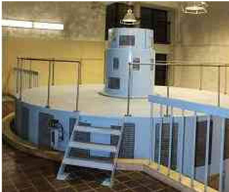
滝波川第一発電所 発電機
