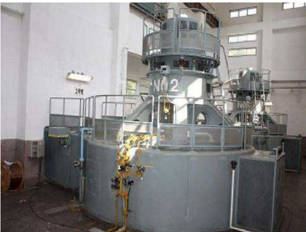
猪谷発電所 発電機
