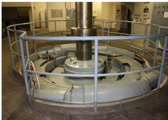
小俣発電所 水車
