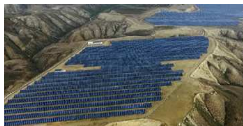
トルコ共和国で稼働中の太陽光発電所 (13,514kW)
