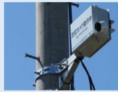
防犯カメラ設置
