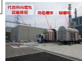
常設代替交流電源設備の設置
